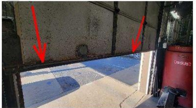
Rusty Overhead Door
