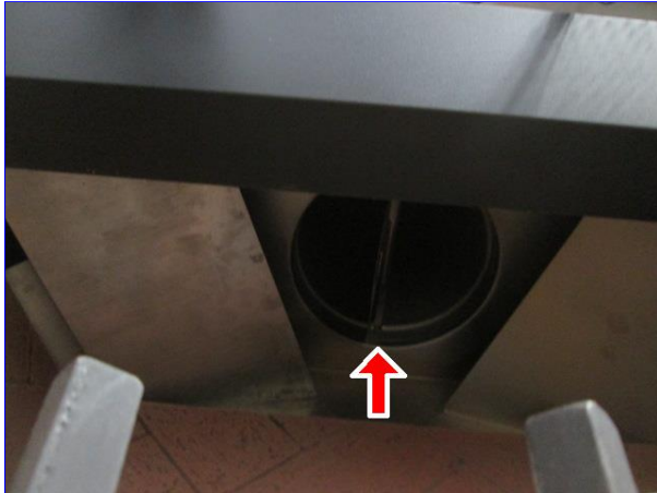
K. Item 1 inside firebox
